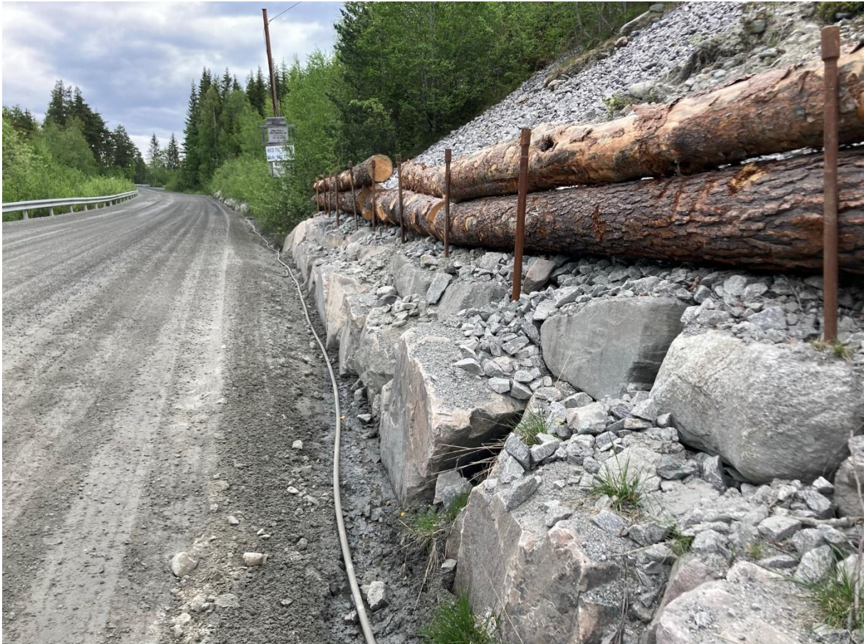
Bilde 2: ras-sikring v/pel 100
